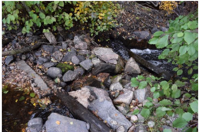
Kuva 41. Vistinkosken padon reunassa valli "vuotaa".
