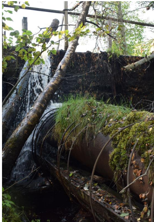
Kuva 13. Voimalaitokseen vesi kulkee putkea pitkin.
